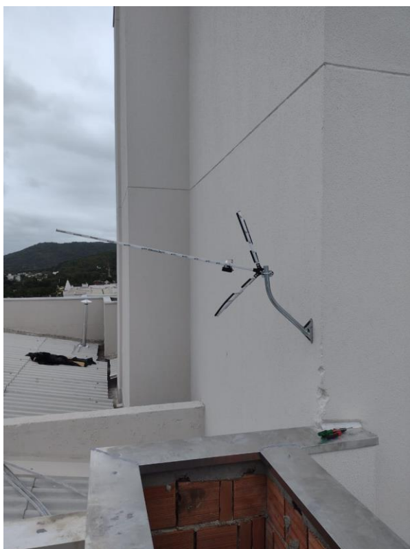
Figura 1 – Local da antena coletiva instalada
