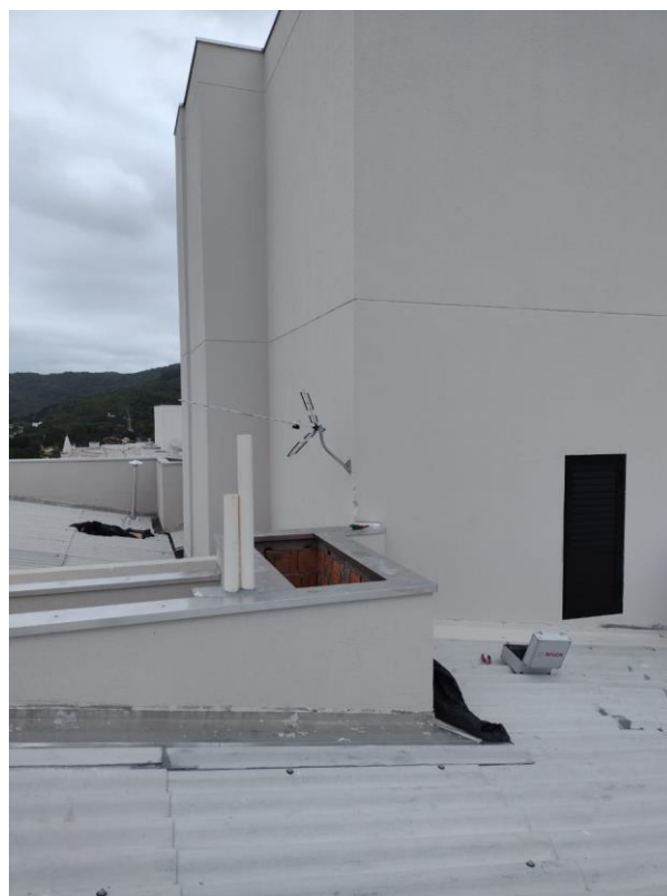
Figura 2 – Local da antena coletiva instalada
